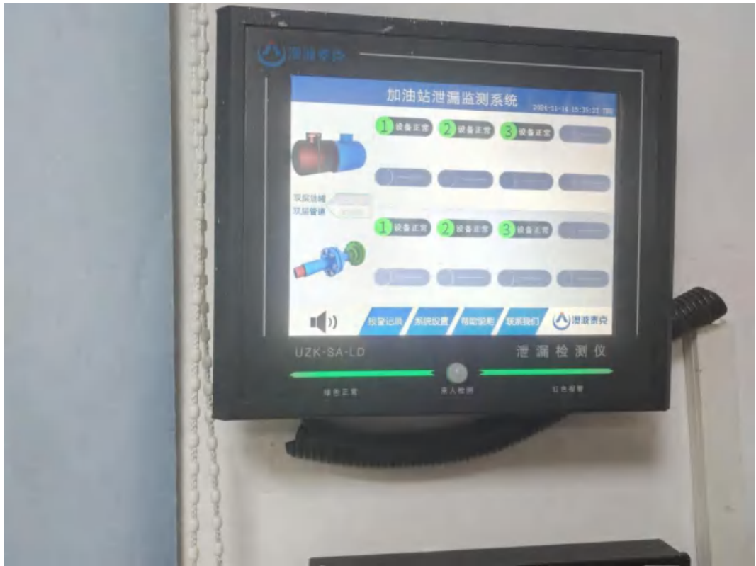
泄漏监测系统图片
