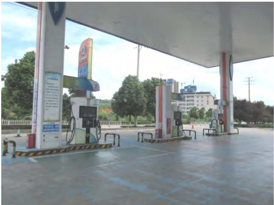
图 2：加油站加油机照片
