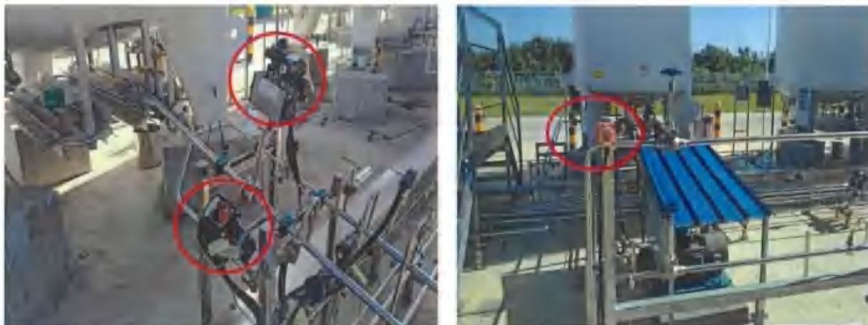
图 2.11-1 紧急切断阀和现场紧急关停按钮
