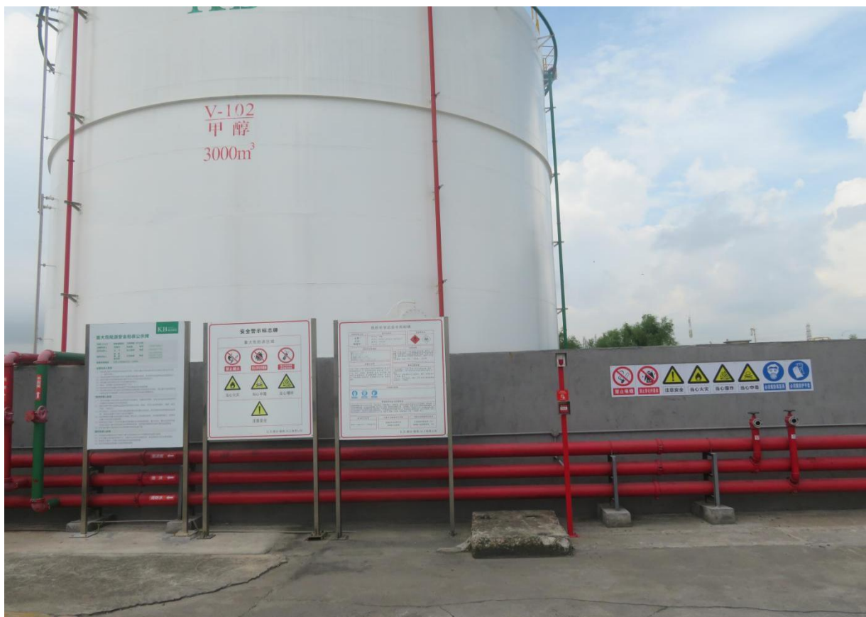
图 2.1-1 重大危险源照片
